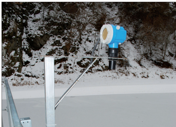
Rys. 8 Czujnik poziomu zainstalowany na tamie
